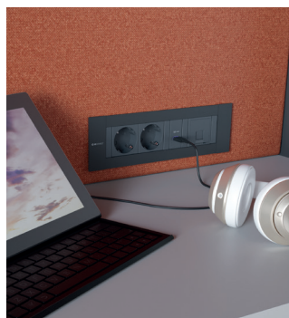
IT. Intro incassato nella parete di una cabina acustica.
