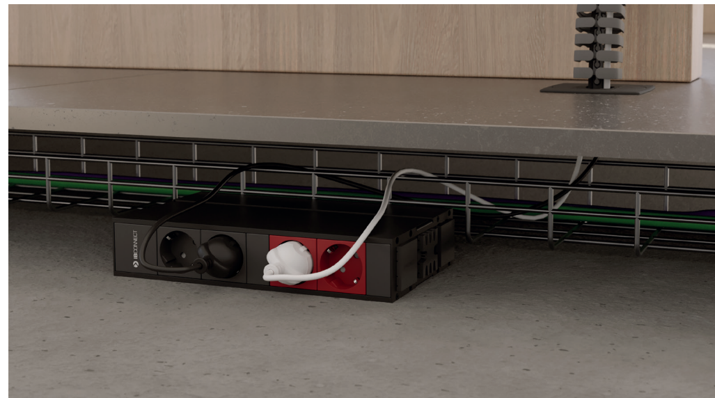
ES. Punto de distribución eléctrica.
