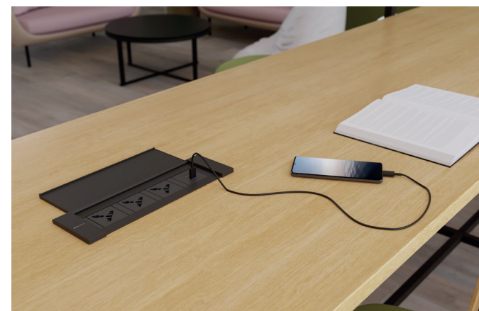
IT. Nexo nero installato nella hall di un hotel.
