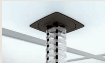
Unit su controsoffitto. Unit in technical ceiling.
